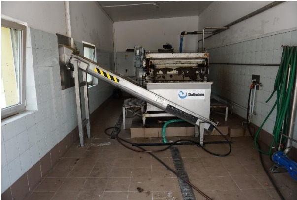
Stacja mechanicznego odwadniania osadów
